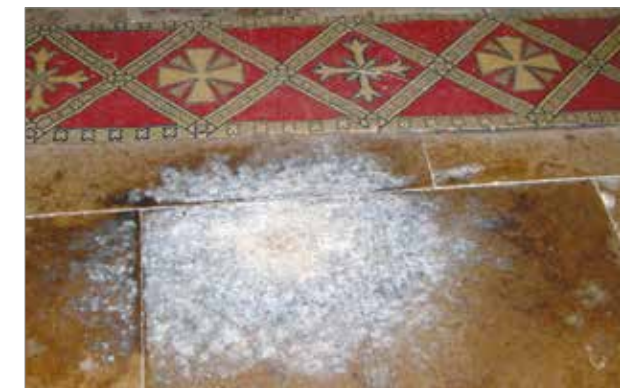
Abbildung 13. Schäden an Steinfliesen im Kloster Penmon, Wales, verursacht durch langjährige Einwirkung von Fledermausurin.
