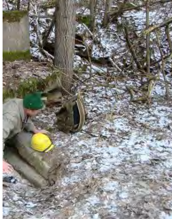
Abb. 4: ungesicherter Eingang am Kaolinstollen Altendorf
